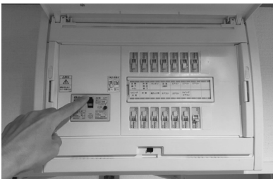
停電が発生したらブレーカーを落としましょう
