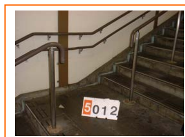
階段踊場の手すりが不連続
