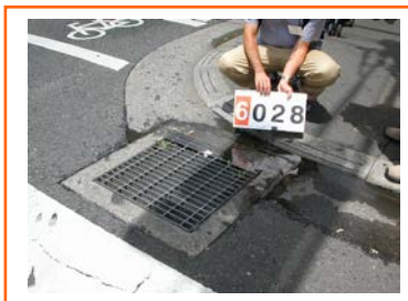
グレーチングの目が粗い
