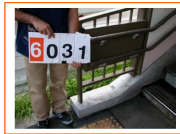
手すりの点字表記がない
